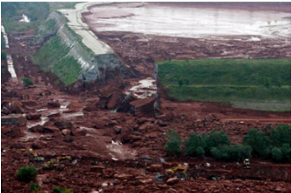
Az ajkai vörösiszap-tározó 10. kazettájának átszakadt északi fala
